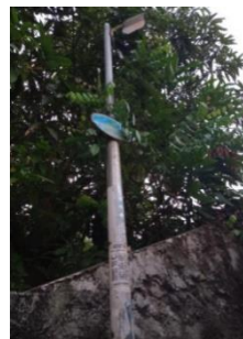
(f) Kondisi salah satu tiang lampu penerang jalan dan masih berfungsi dengan baik.
