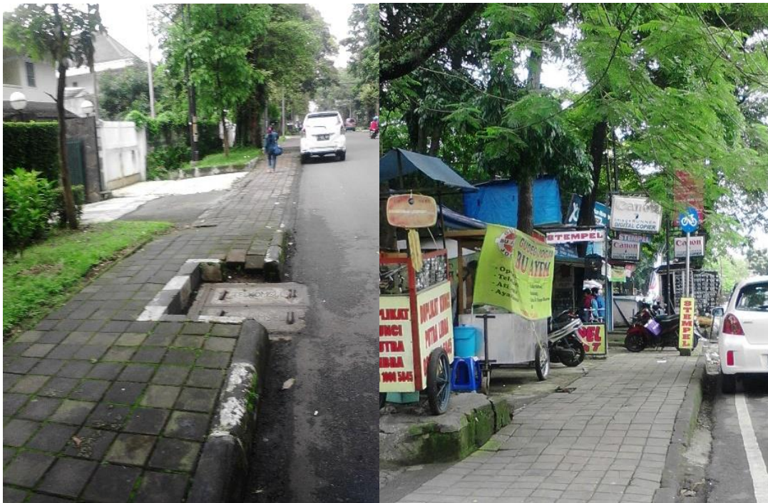
Gambar Kondisi Trotoar Jalan Dipati Ukur
