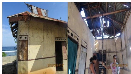
Gambar Rumah Tidak Layak Huni
