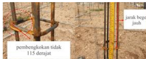
Gambar 14. Kolom Perumahan P1 Sumber : Dokumentasi Penulis, 2021
