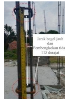
Gambar 15. Kolom Perumahan P2 Sumber : Dokumentasi Penulis, 2021
