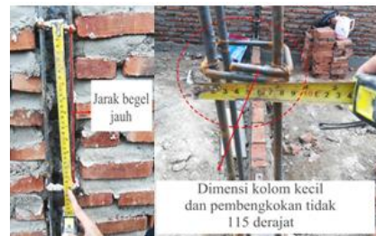
Gambar 16. Kolom Perumahan P3 Sumber : Dokumentasi Penulis, 2021
