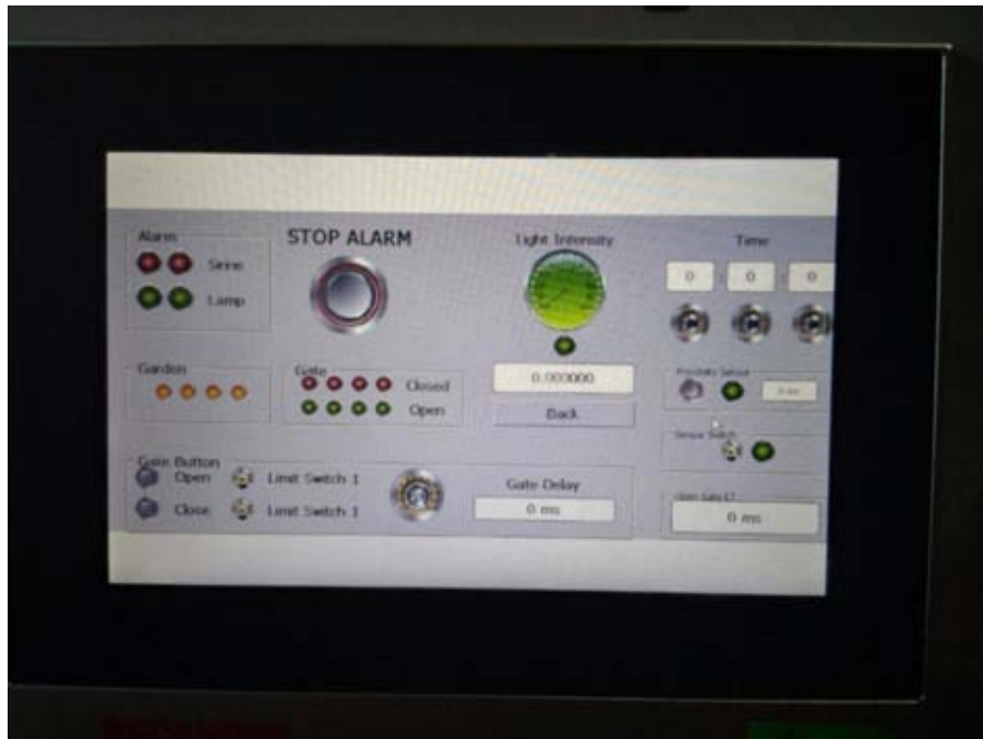
Gambar 11 Realisasi HMI simulasi sistem keamanan bangunan pada Control Panel
