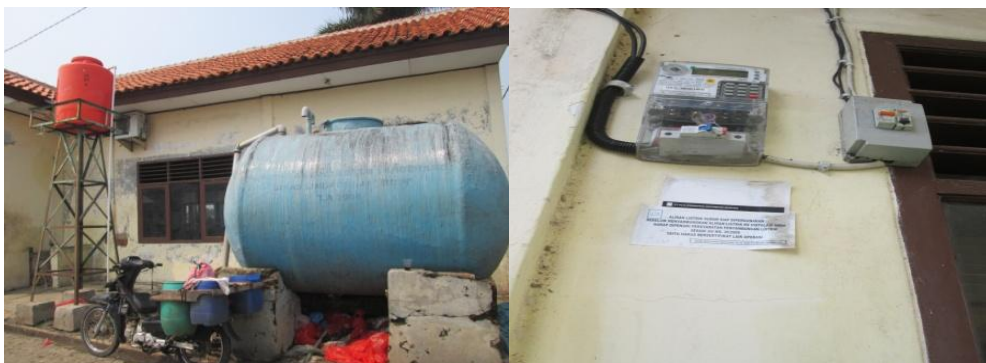
Gambar 5. Tangki air bersih (kiri) dan instalasi listrik (kanan) di PPI Kronjo.
