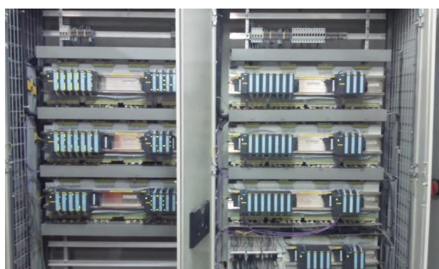
Gambar 10. Modul I/O Cooler
