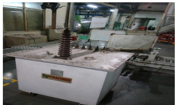
Gambar 2. Transformator Step-Up (Sumber : PT.Trafoindo Prima Perkasa)
