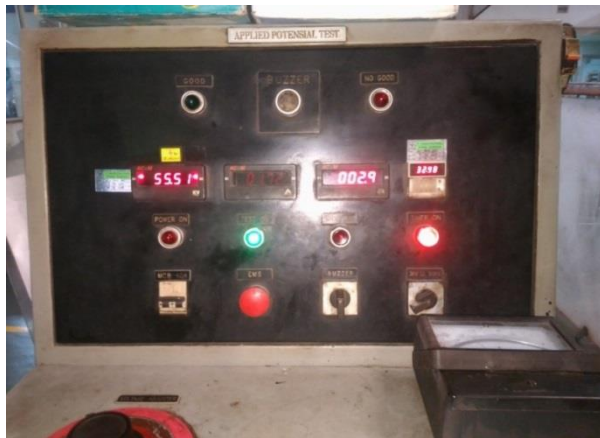
Gambar 1. Applied Potensial Test (Sumber : PT. Trafoindo Prima Perkasa)
