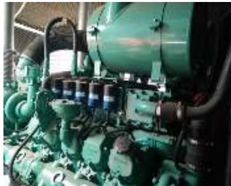
Gambar 4. Generator Set 320 kva
